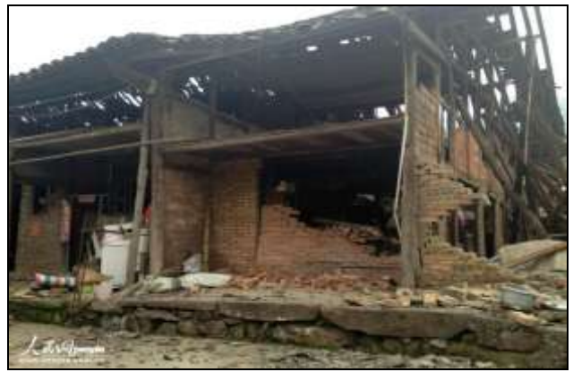
災區的部分房屋損毀嚴重
